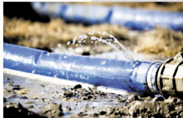
Figura 1.85 Las pérdidas por deterioro de tuberías, contenedores, grifos, mangueras, tinacos y cisternas son una de las formas más comunes de desperdicio de agua.
